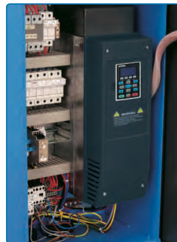
Quadro elettrico e inverter.
